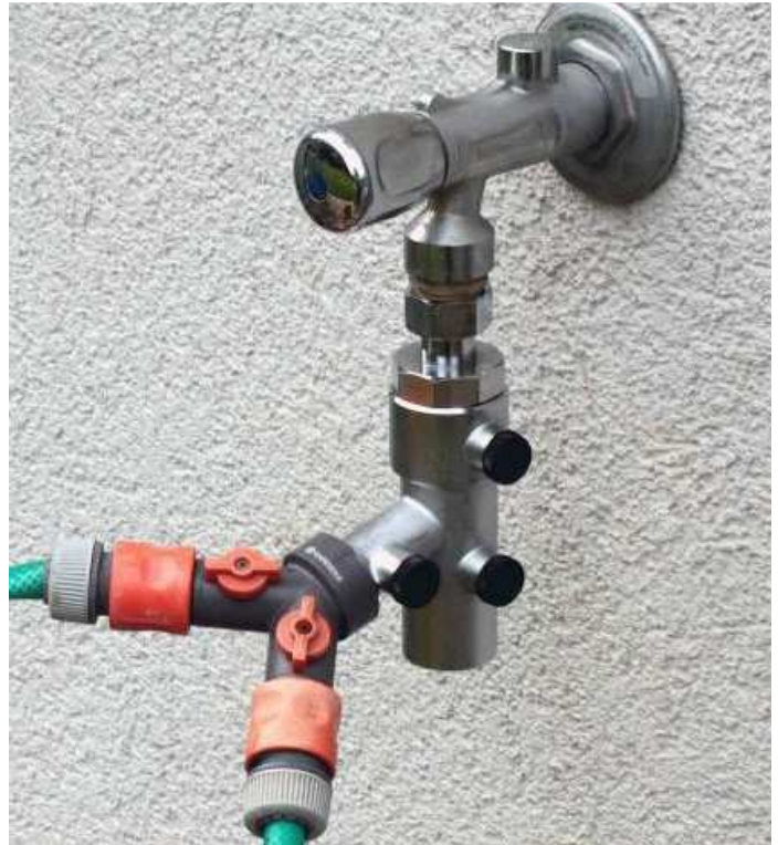
Beispiel frostsichere Entnahmearmatur mit Systemtrenner zur Gartenbewässerung.
